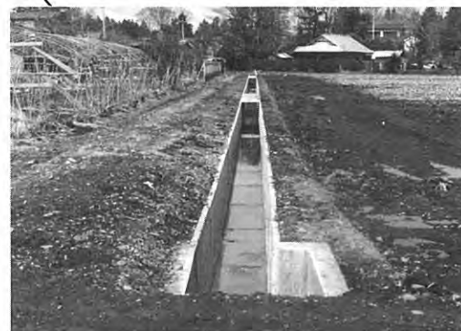
農村総合整備モデル事業 (集落排水施設整備・愛宕町地区)
