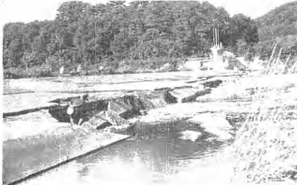
穴堰頭首工の災害状況
