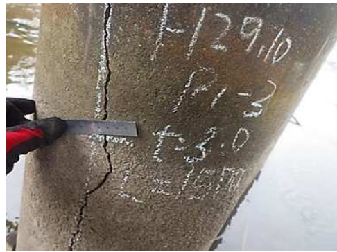
礼堂橋：パイルベント橋脚のひびわれ
