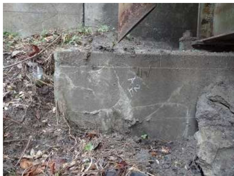
10. 3-3号橋(横穴橋)：鋼I桁橋 (橋長：34.85m、1972年竣工) 橋台前面の遊離石灰を伴うひびわれ
