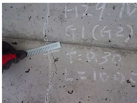
48. 中川橋：RC T桁橋 (橋長：26.84m、1966年竣工) 主桁下面及び側面の鉛直方向ひびわれ (最大幅0.3mm)
