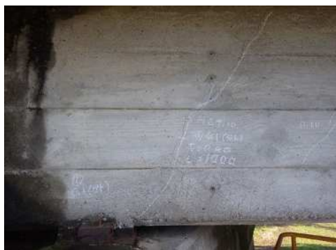
10. Ⅲ-5号橋(下宿橋)：RC T桁橋 (橋長：30.40m、1965年竣工) 主桁下面及び側面の鉛直及び斜め方向 ひびわれ (最大幅0.4mm)
