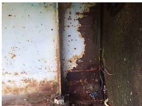
高屋橋：主桁の腐食
