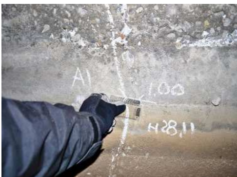
02. I-1橋：RC床版橋 (橋長：6.60m、1954年竣工) 橋台前面の鉛直方向ひびわれ (最大幅1.0mm)
