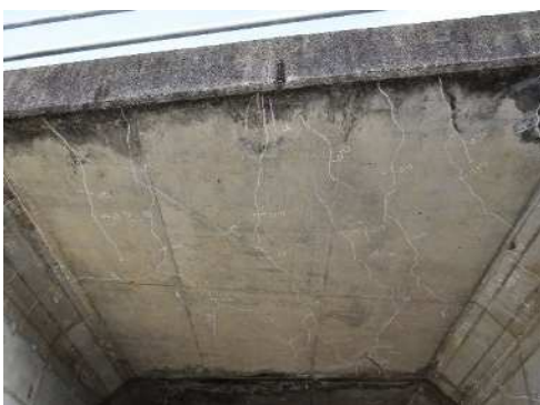
09. 3-2号橋：ボックスカルバート橋 (橋長：3.65m、1972年竣工) 床版下面の2方向ひびわれ (最大幅0.8mm)
